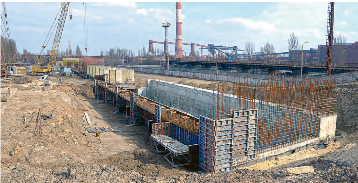
На этом объекте необходимо уложить 3200 кубометров бетона, строители уже приняли около 2000 кубов, или почти 60 процентов.
