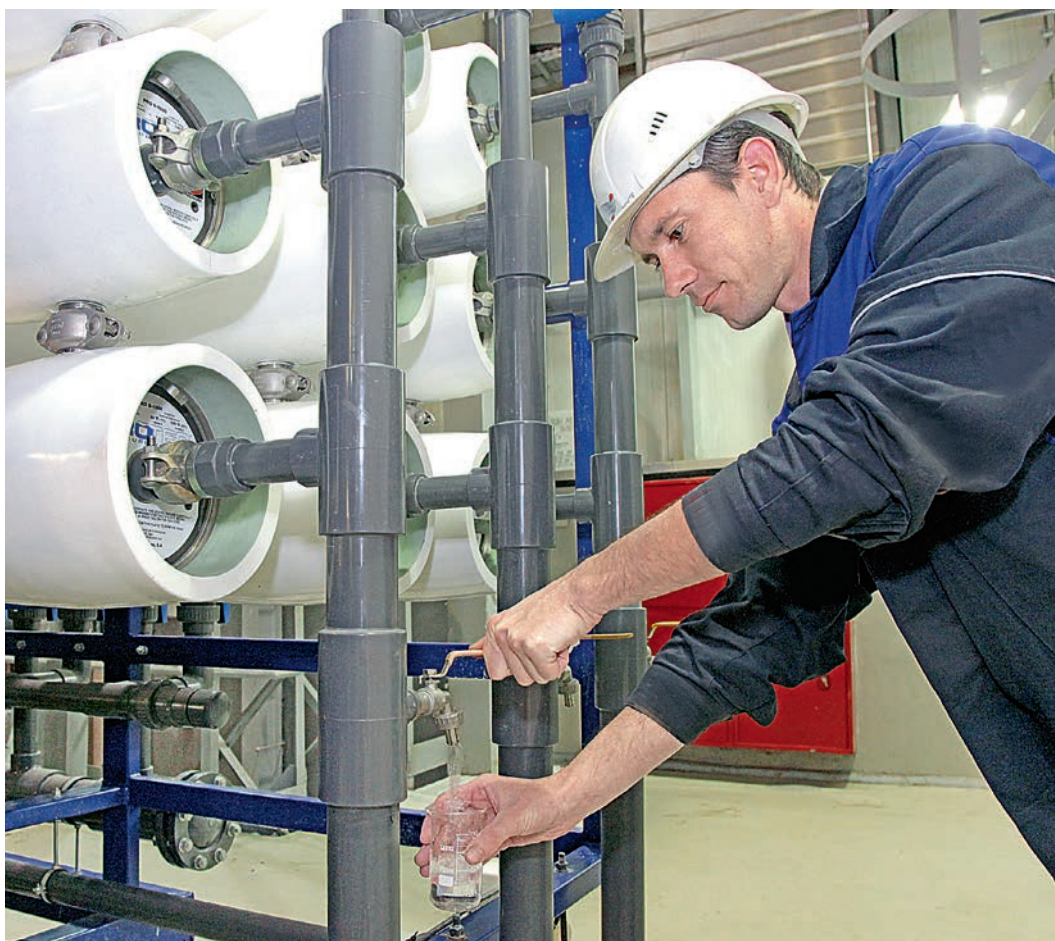
Установка очистки сточных вод. Машинист насосных установок Геннадий Мальцев.
