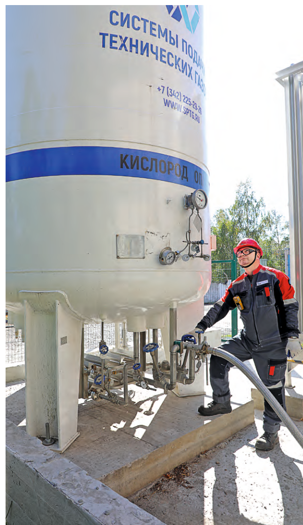
▲ Такое оборудование обслуживают слесари-ремонтники, обученные по профессии «аппаратчик воздухоустройства»
