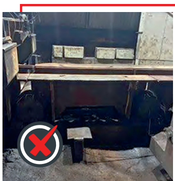
▲ Открытая зона работающего оборудования на участке печей
