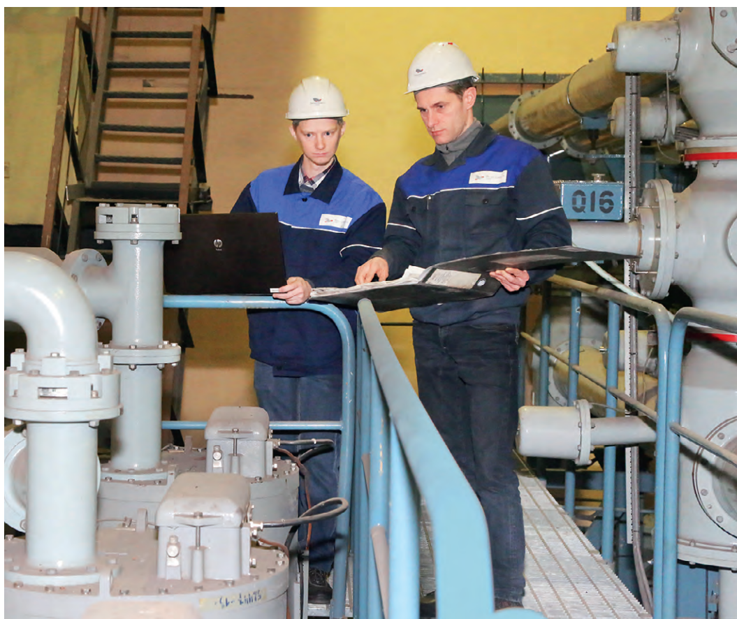
Установка трансформаторов более высокого класса точности позволит эффективнее учитывать потребляемую электроэнергию.
