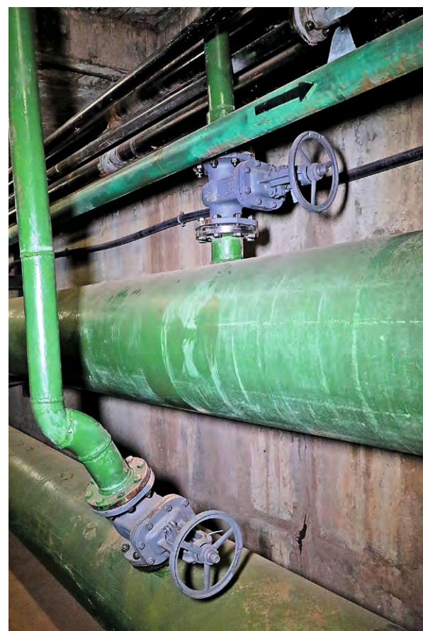
▲ Небольшие перемычки не только защищают оборудование, но и экономят электроэнергию
