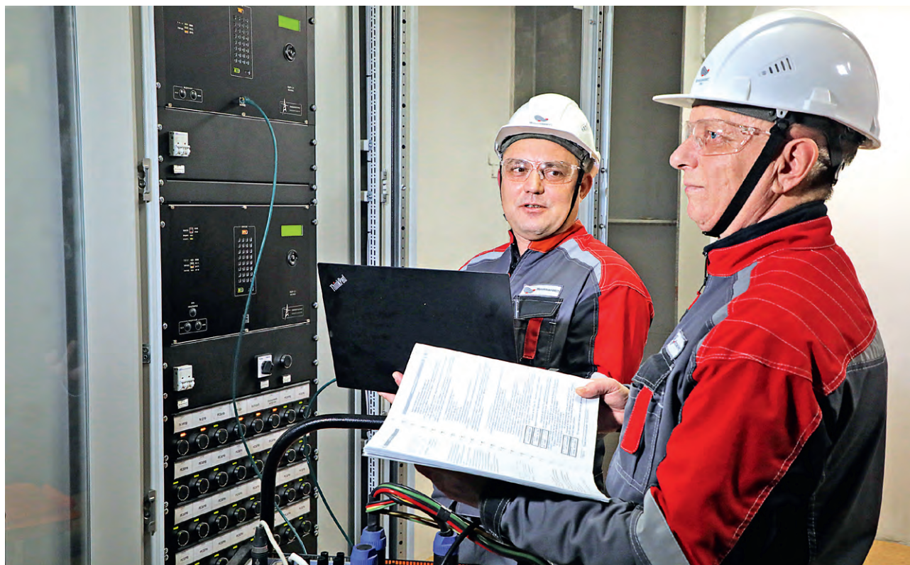
▲ Начальник лаборатории релейной защиты ЦЭТЛ Роман Пятак и ведущий инженер Александр Васильев ведут проверку высокочастотных каналов связи с подстанцией «Металлургическая-750»
