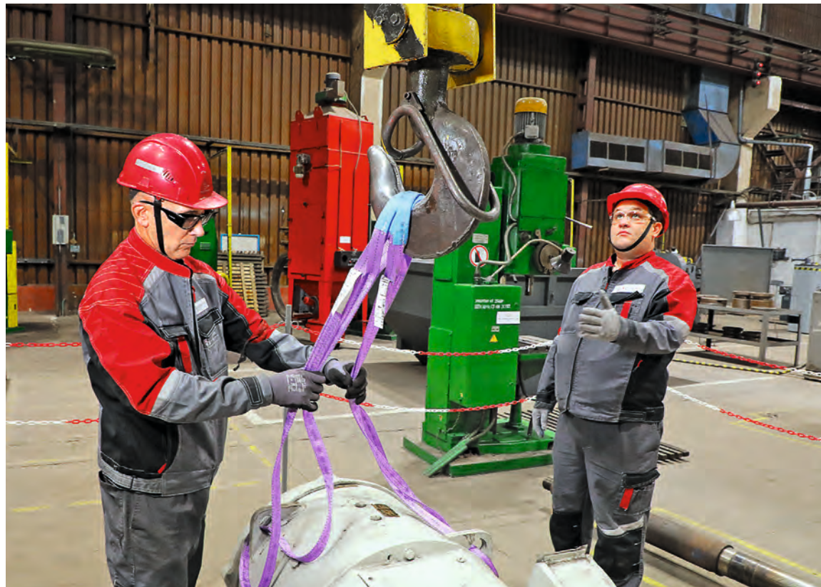
▲ Электромонтёры по ремонту электрооборудования Альберт Гончаров и Сергей Мишин ведут строповку электродвигателя на полигоне
