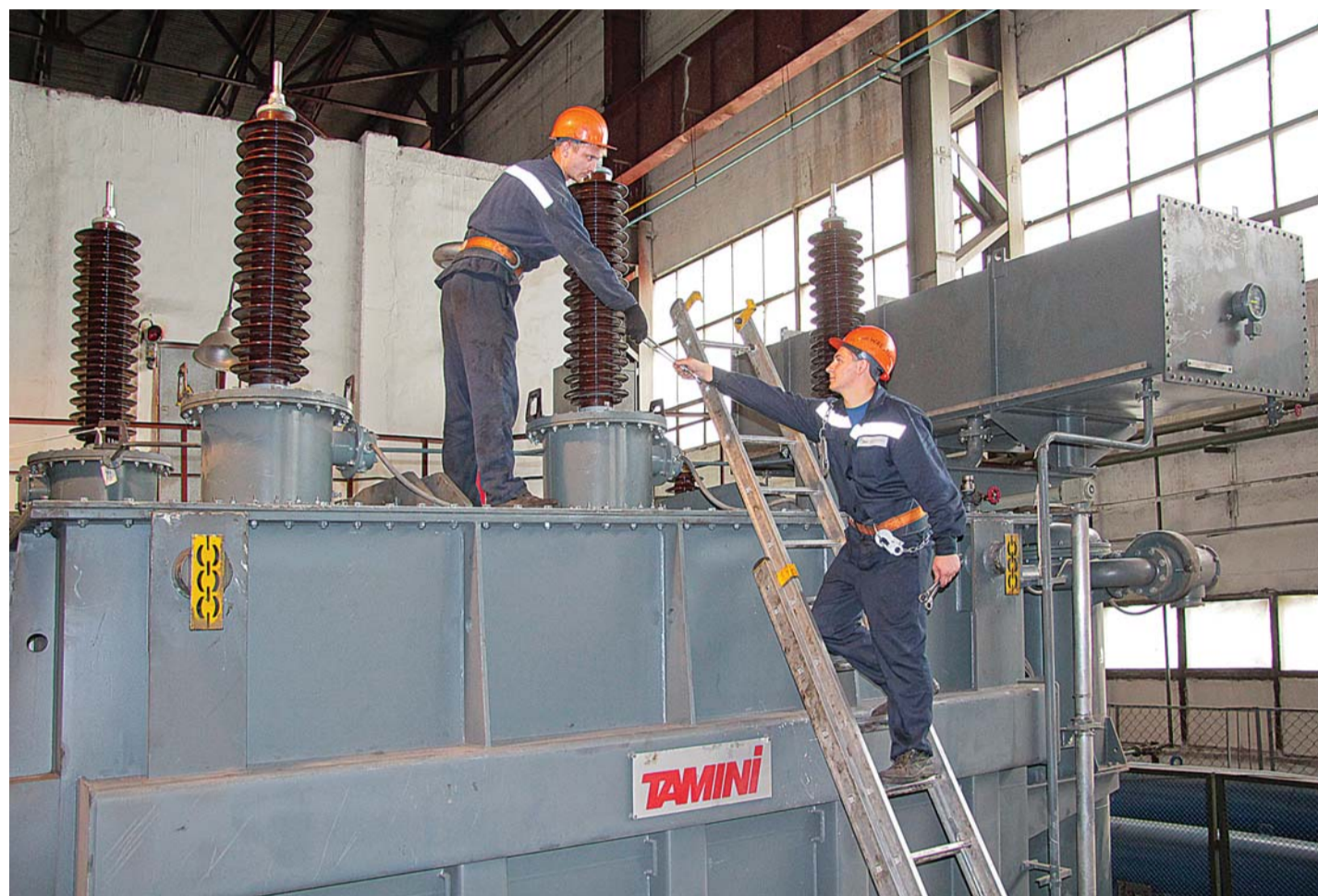
Электромонтёры по ремонту обмоток и изоляции ЭЭРЦ Дмитрий Бурнашев и Евгений Степанов ведут монтаж вводов 110 киловольт.
