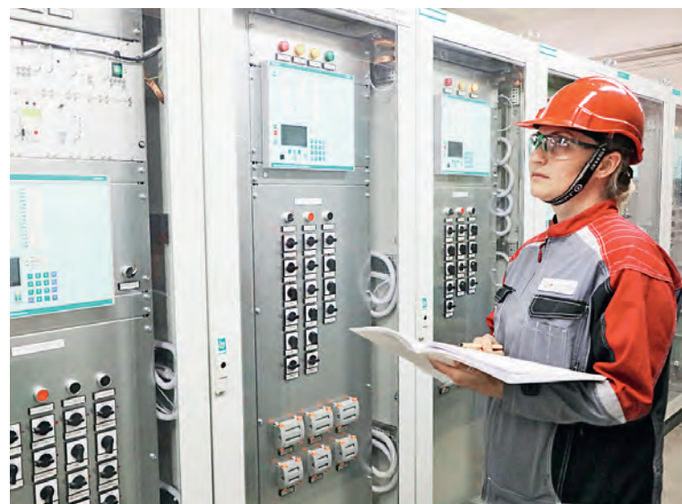
▲ Наталия Хохлова контролирует работу электрооборудования
