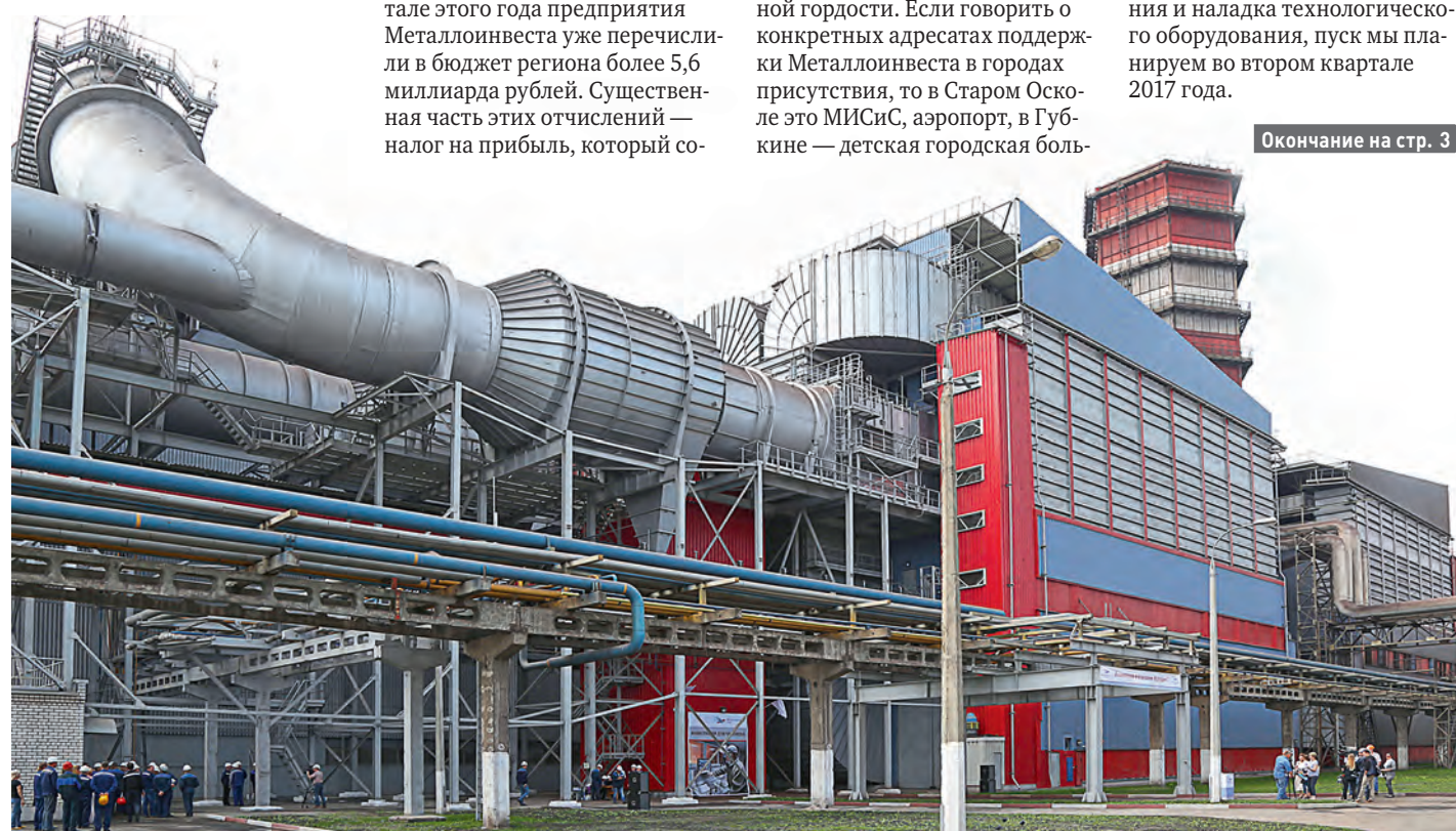
Комплекс газоочистки в электросталеплавильном цехе ОЭМК — один из важных экологических проектов Металлоинвеста.
